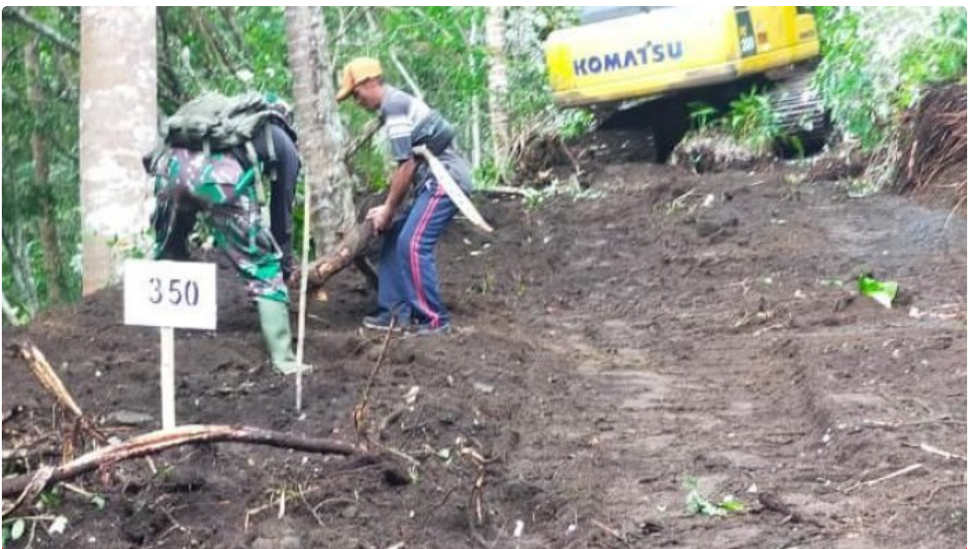
Pembukaan Akses Jalan oleh Satgas TMMD Ke-116 di Kelurahan Tandurusa. capai 350 Meter
