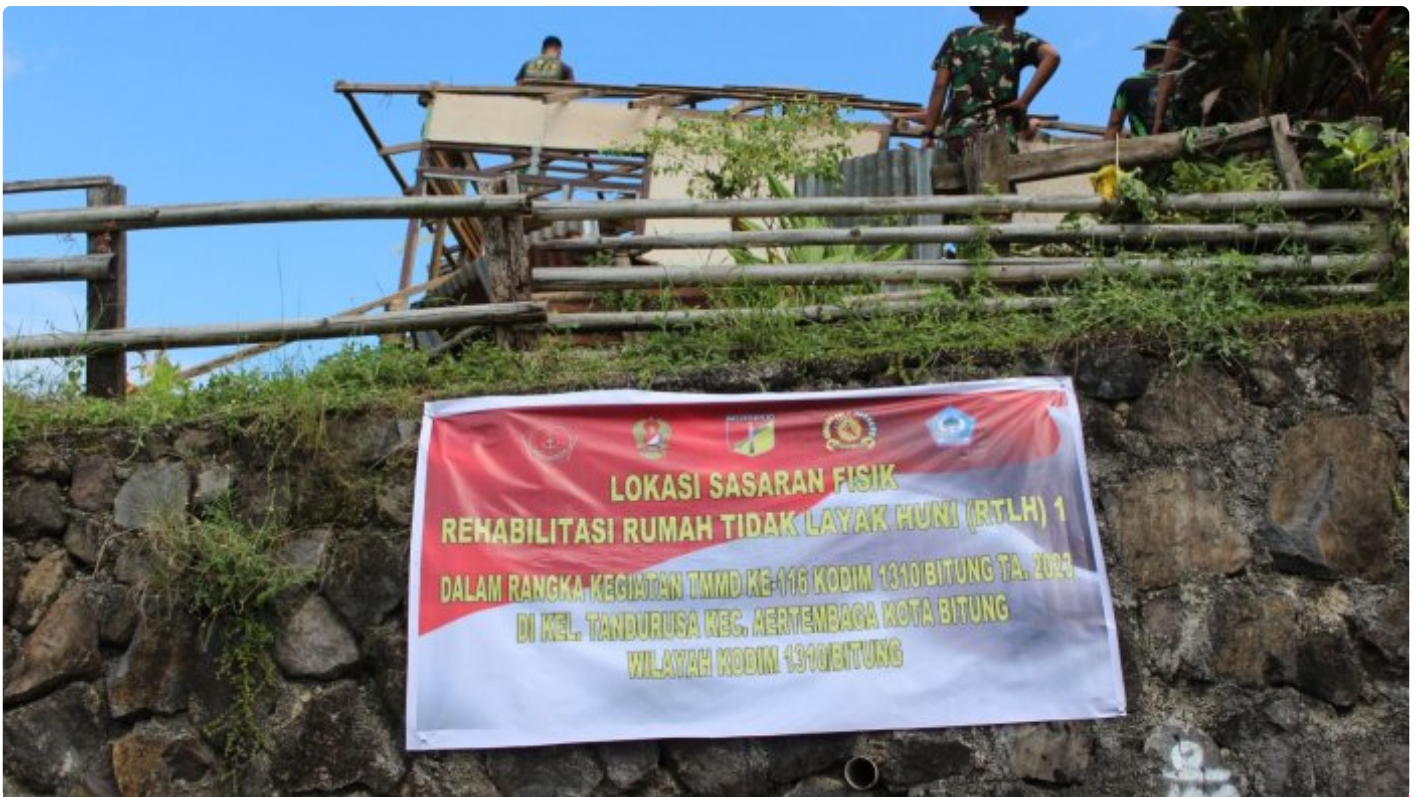
Kegiatan Pembangunan Rumah Tidak Layak Huni (RTLH) oleh Satgas TMMD Ke-116 di Kelurahan Tandurusa
